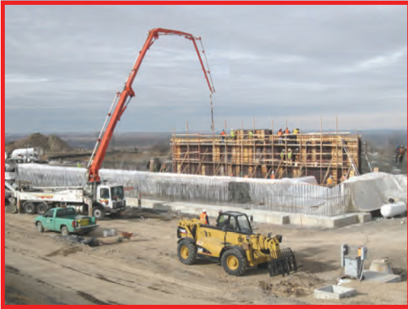
Oxidation ditch wall pour.
